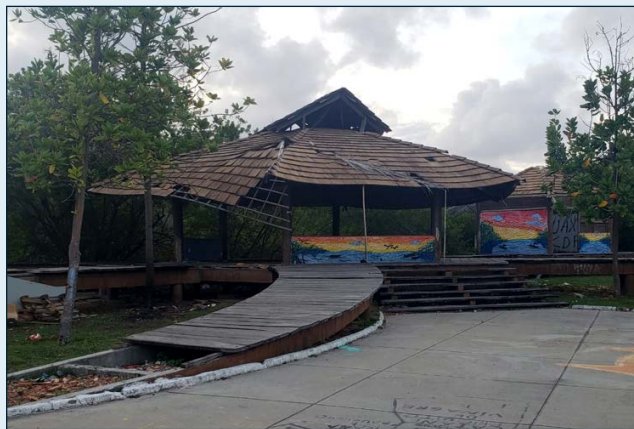
Figura 09 – Equipamentos públicos deteriorados
